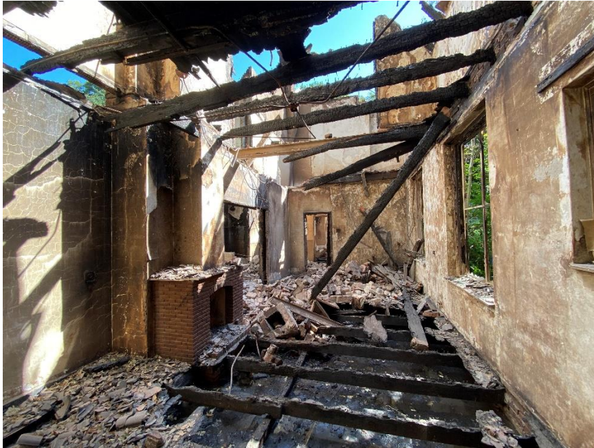
Afb. Het linkerdeel van het voorhuis. Balklagen zijn verloren gegaan door de brand.
