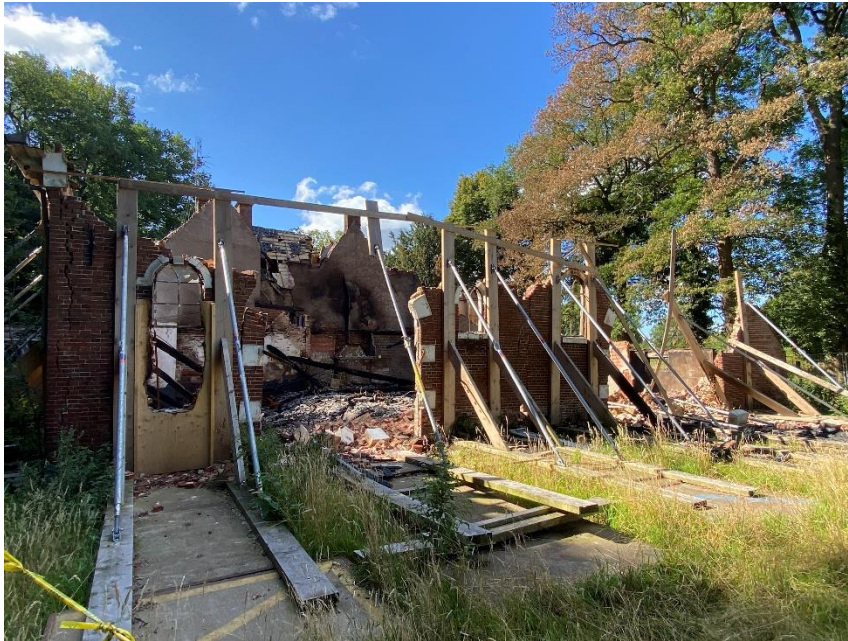
Afb. Restanten van de gevels van de achterhuizen, alleen de steenachtige onderdelen staan nog deels.
