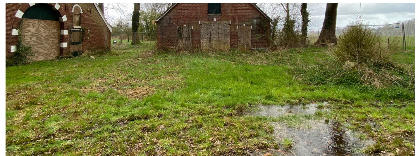
Waterprobleem op het huidig centrale erf tussen gebouw A en C
