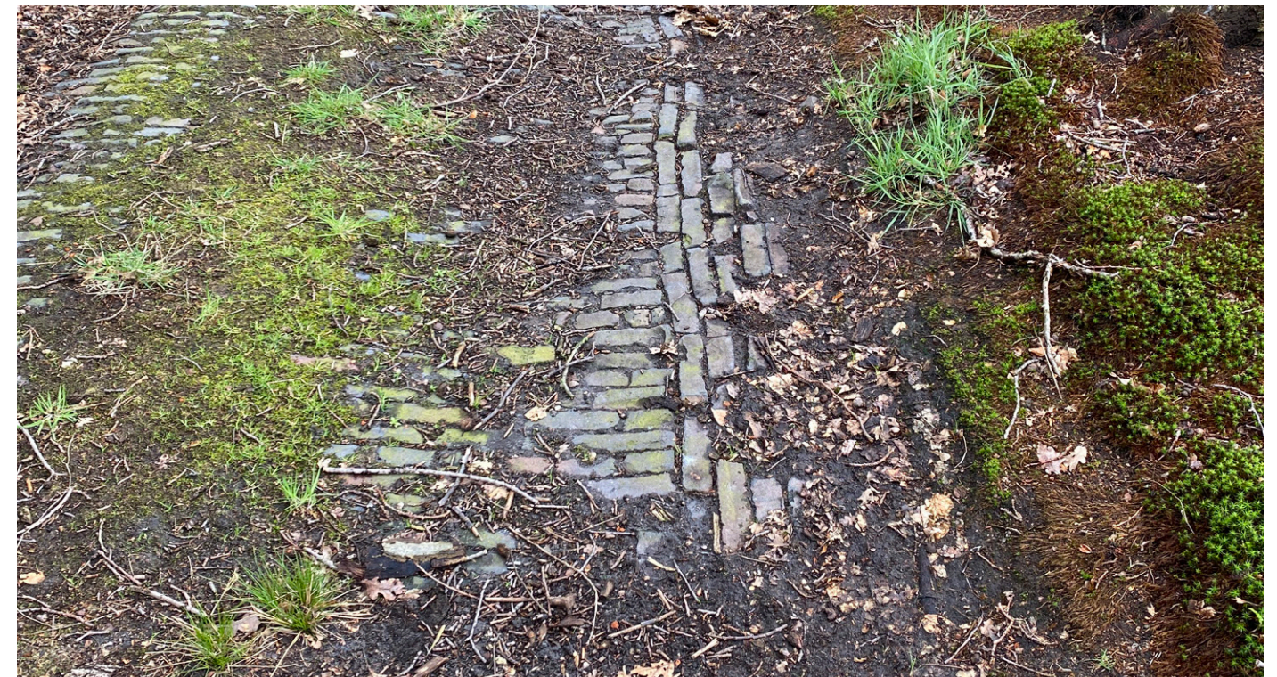
Bestaande verharding van gebakken klinkers met verzakkingen en vervuiling van mos
