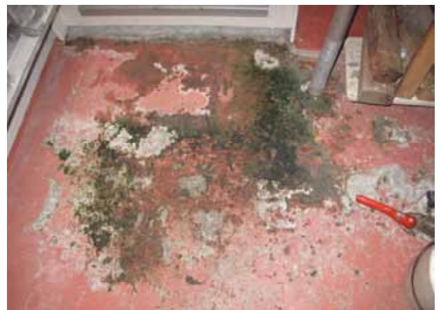
Schimmelvorming door hoge grondwaterstanden
