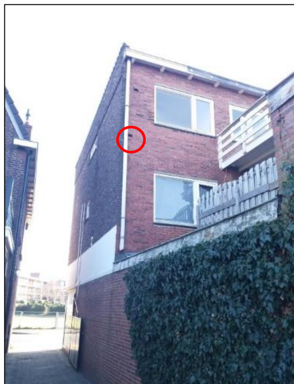
Foto 2. Detail woningcomplex met gat in muur (rode cirkel).
