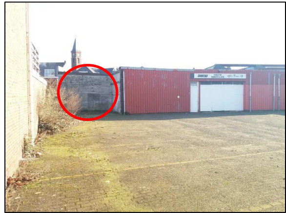
Foto 8. Muurtje met ventilatievoegen (rood omcirkeld).
