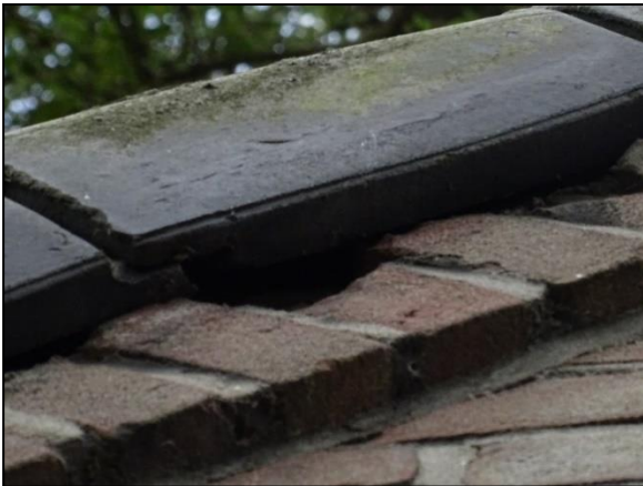
Figuur 20. Ruimte bij kantpannen geeft toegang voor vleermuizen onder de dakpannen.
