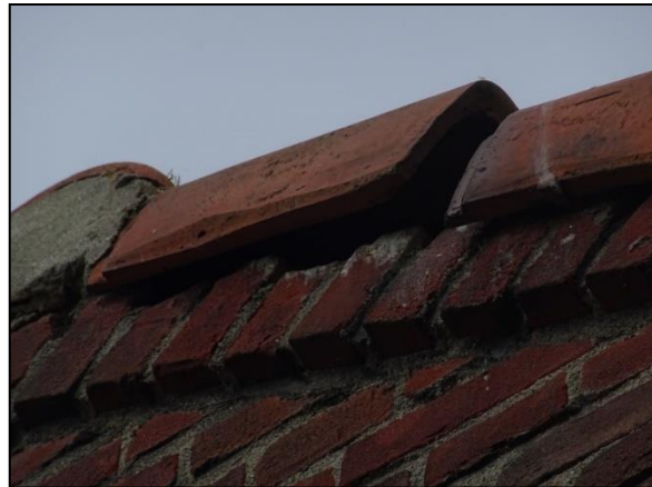
Figuur 21. Ruimte bij kantpannen geeft toegang voor vleermuizen onder de dakpannen.
