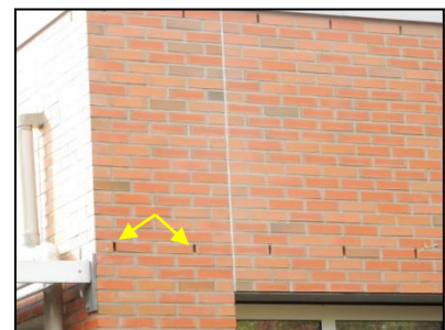
Figuur 8. Stootvoegen die toegang verlenen tot de spouwmuur voor vloermuizen.
