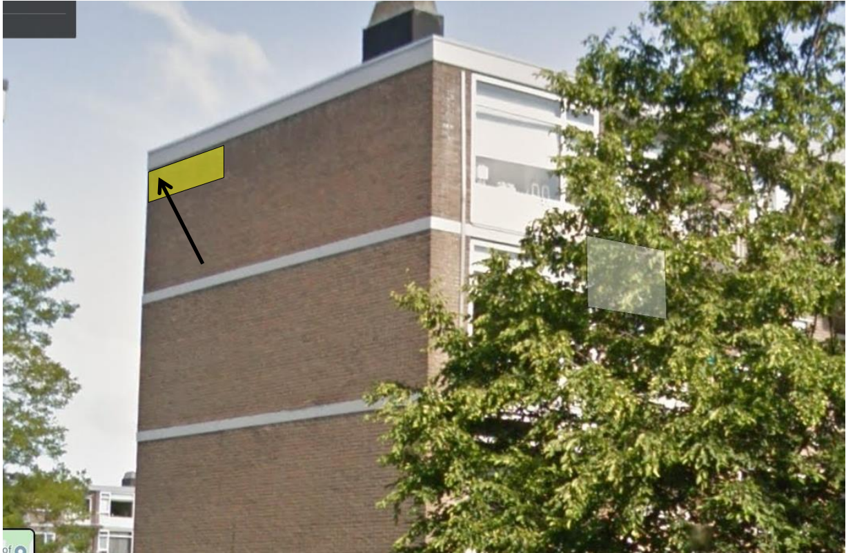
Uitvliegopeningen van de kraamkolonie. Deze wordt met de pijl aangeduid. De vleermuizen houden zicht vermoedelijk op in de spouw in het gele vlak. Mogelijk bezetten ze ook een verblijfplaats, met om de hoek van het gebouw.
