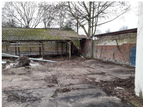
Schuur met asbesthoudende dakbedekking
