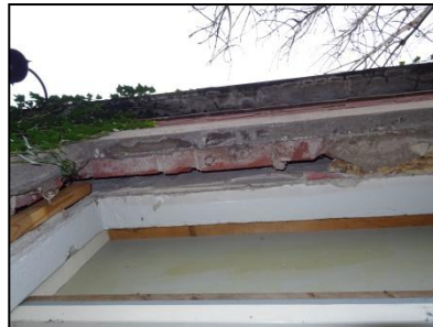
Figuur 11. Recentelijk ontstane opening naar de spouwmuur van gebouw 1.
