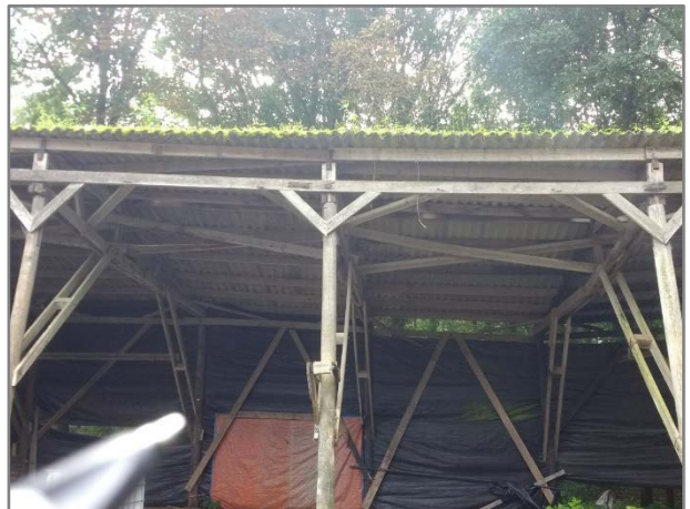
Foto 4: voormalig opslag hooi en stro, asbest verdachte platen
