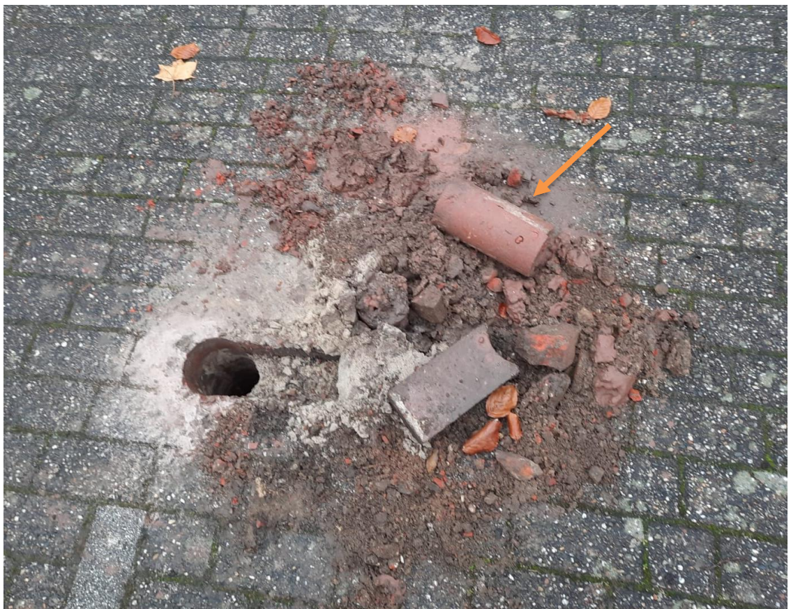
Afbeelding 13. Boring 1 met de uitgeboorde puinlaag. Met de pijl is het massieve stuk (bak)steen aangegeven.
