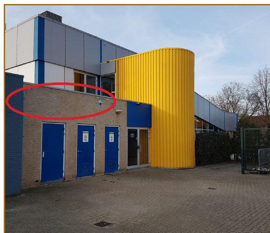
Afb. 2.4: Oostgevel hoofdgebouw, met in rood aangegeven locaties van voor vleermuizen geschikte open stootvoegen.
