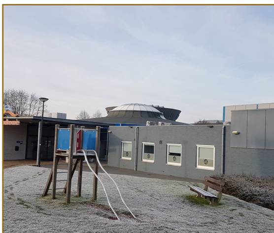
Afb. 2.3: Hoofdingang van het hoofdgebouw. Ook hier zijn open stootvoegen aanwezig in het gemetselde, niet met gevelplaten beklede deel.
