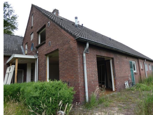
Afb. 35 Voorhuis uit de jaren twintig, waarbij in de jaren zeventig de vensteropeningen zijn aangepast.
