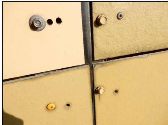
Figuur 11. Op plekken waar reparaties hebben plaatsgevonden is de tussenruimte soms iets groter. Een rubberen strip voorkomt dat er inkruiptmogelijkheden voor vleermuizen zijn.
