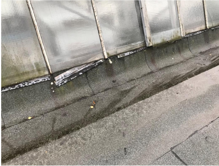
afb. 8 Veel loodslabben onder de beglazing ingescheurd of weggevallen
