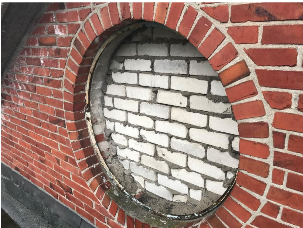
afb. 7 Stalen roosvenster kapot en/of aangeroest, opening aan binnenzijde dichtgemetseld
