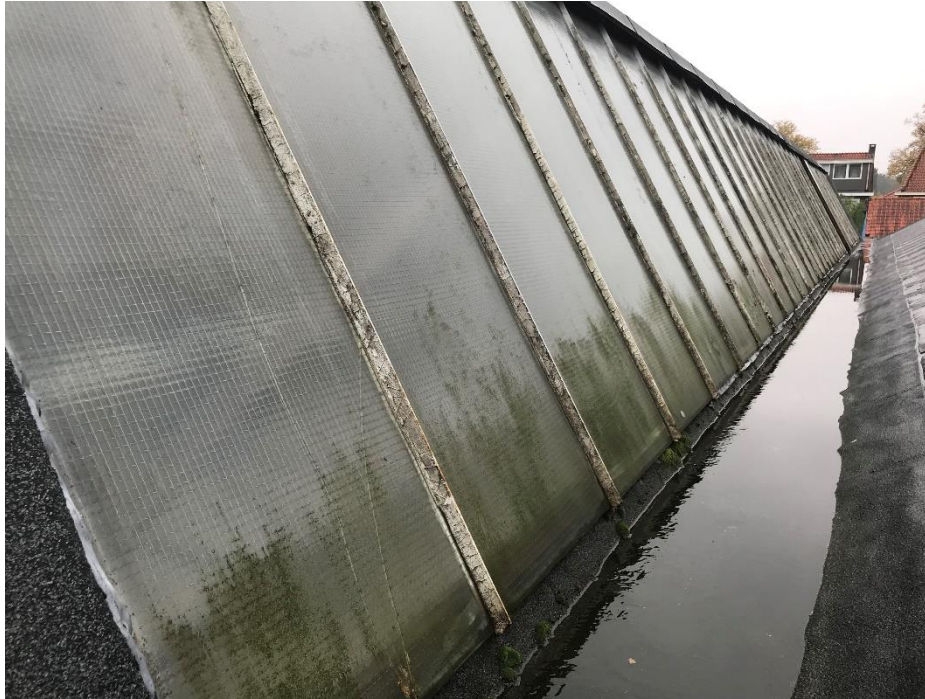
afb. 3 Slechte afwatering in de zakgoten, kapotte beglazing en opgeroeste glasprofielen
