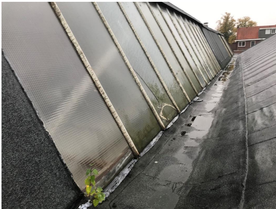
afb. 4 Kapotte beglazing en weggezakte loodslabben
