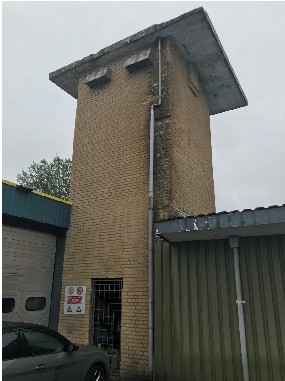
Afb. 11 De zogenaamde plofbunker, redelijk metselwerk, maar de afdekking in een slechte staat. Langdurige lekkage langs de hemelwaterafvoer, waardoor het voegwerk is uitgespoeld en het metselwerk is vervuild en verzadigd
