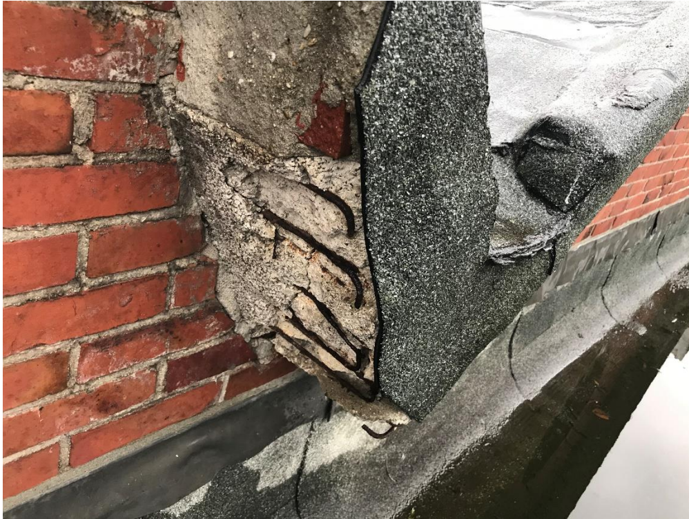
afb. 6 De onderzijde van de betonafdekkingen zwaar aangetast
