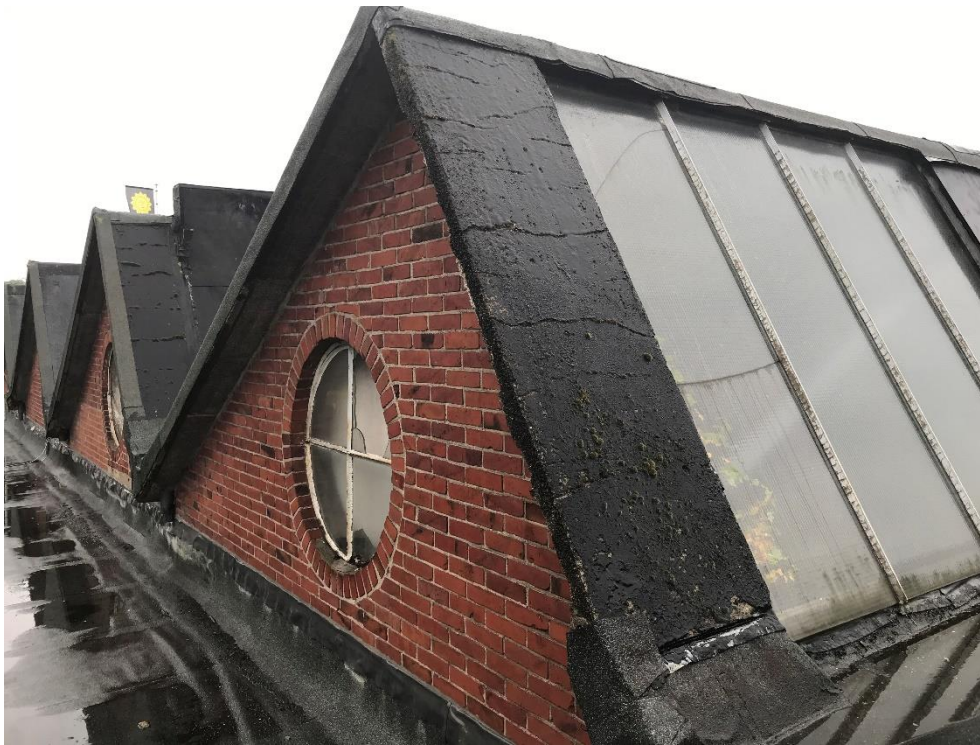
afb. 5 Redelijk metselwerk van de topgevels, afdekkingen zwaar aangetast
