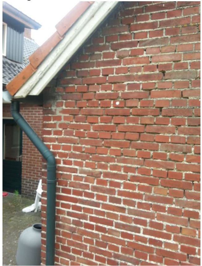
Foto : Uitgesleten metselmortel
