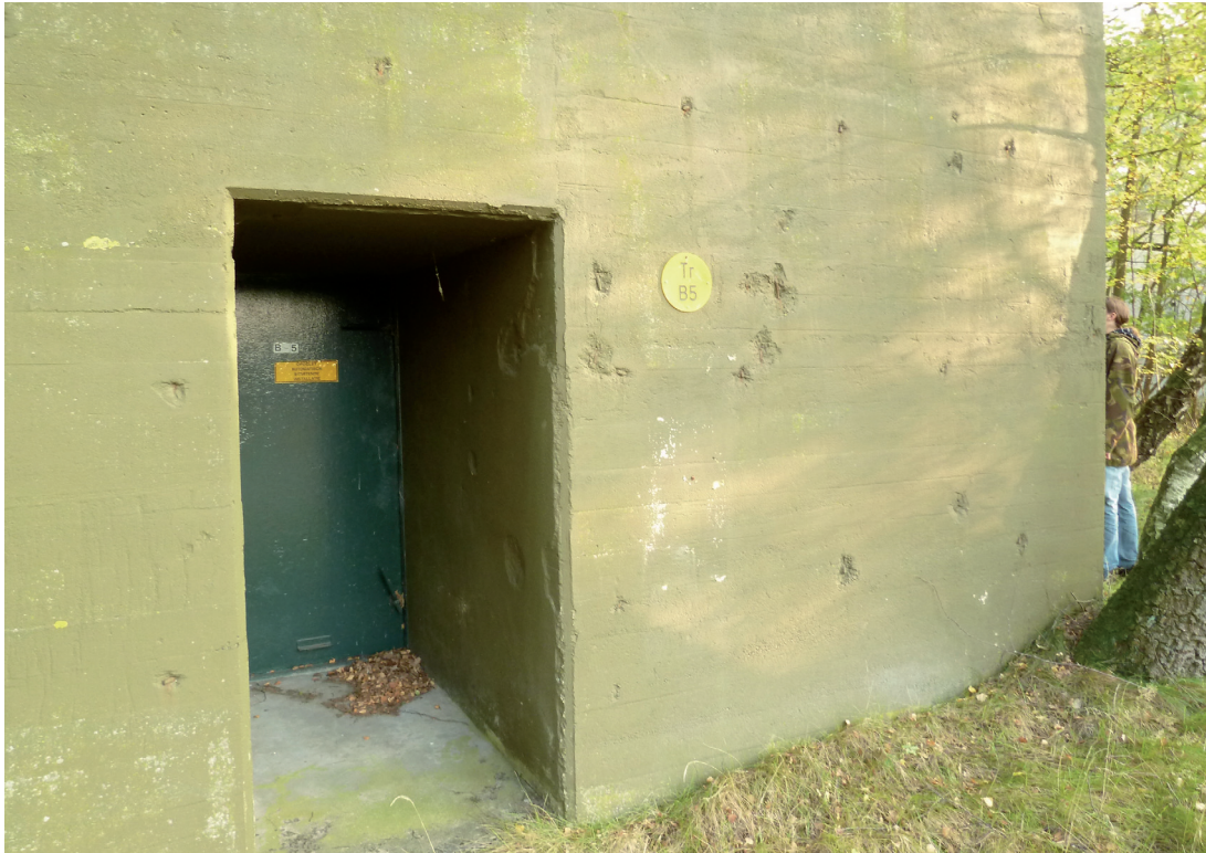
Figuur 15. Een trafohuis oost van de vlieggebouwen (inspectie nr. 3) vertoont sporen van beschietingen.
