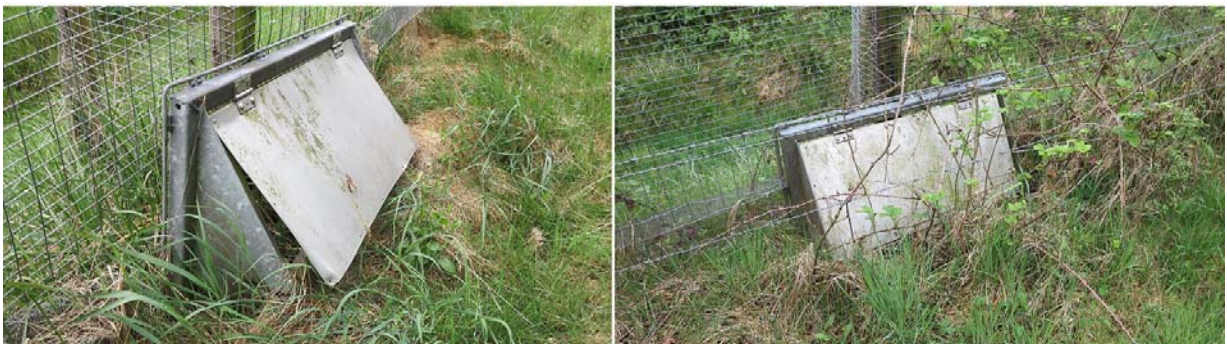
Defecte dassenpoorten in het wildraster langs de N35.
