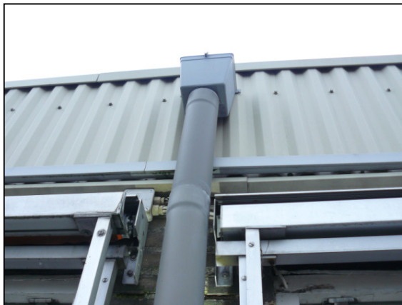
Figuur 6: Onder dakranden is geen ruimte voor vleermuizen.
