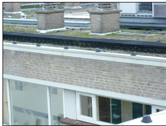
Figuur 5: De bovenste spouwruimte, op 5 verdiepingen hoog is plaatselijk niet gevuld.
