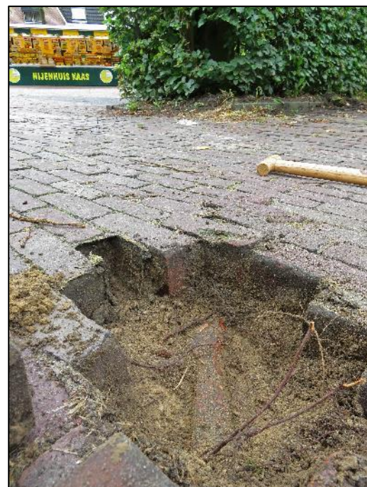
Figuur 12 Oppervlakkige wortels onder het voetpad
