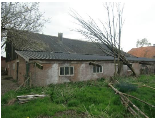
Afbeelding 5.7. Links boven: impressie voorzijde gebouw. Rechts: nest nok van het dak. Links onder: impressie achterzijde.
