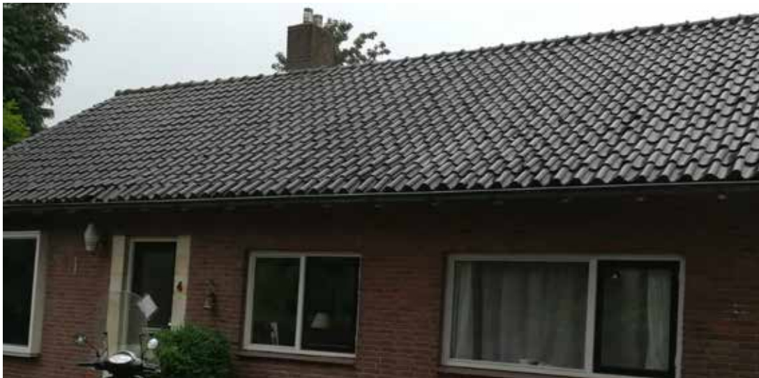
Kerkdijk 4, losliggende dakpannen.
