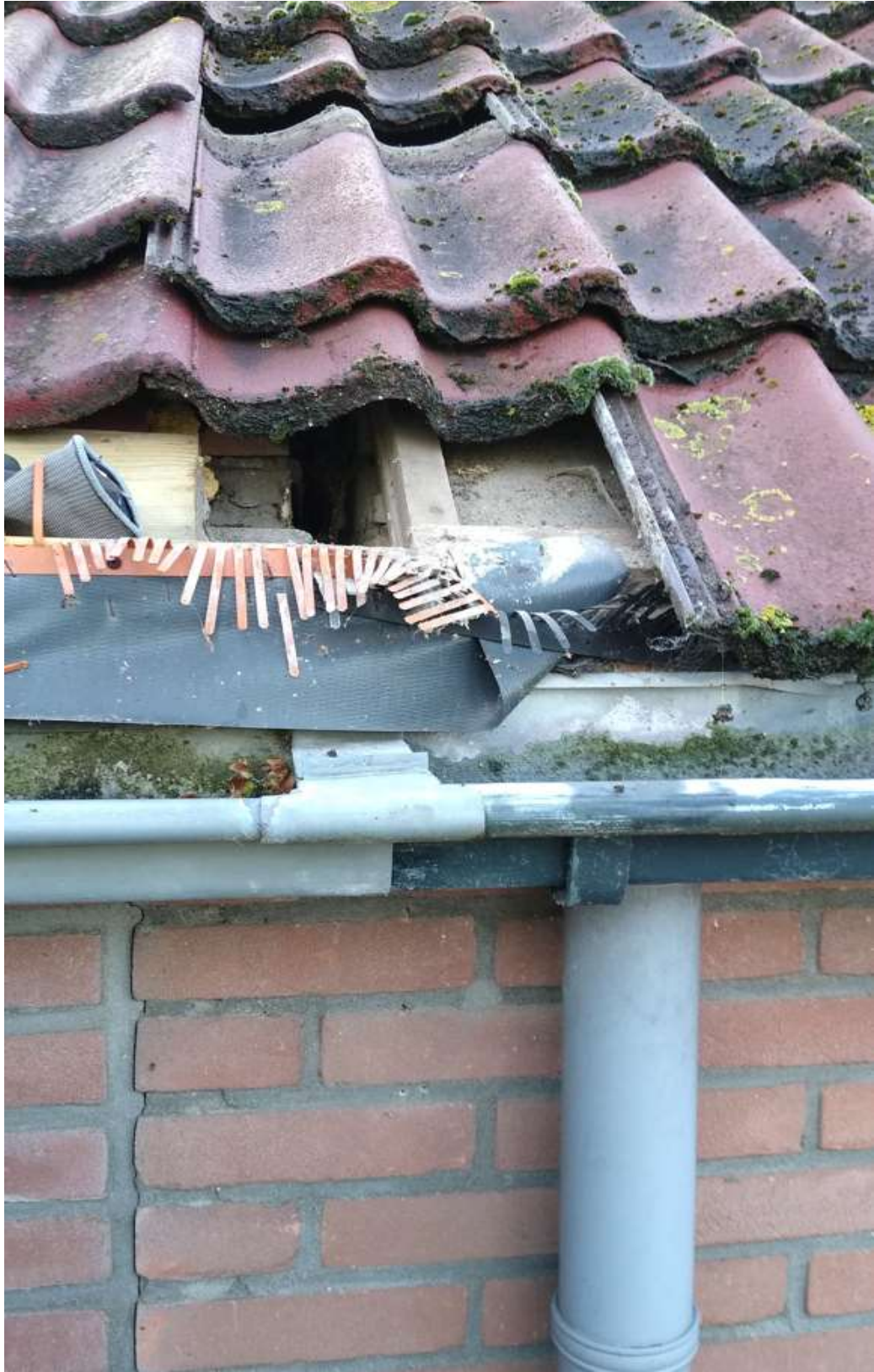
Ter plaatse van de woningscheidende wand is de dakplaat incl. bovenliggende panlat onderbroken, zie bovenstaande foto.
