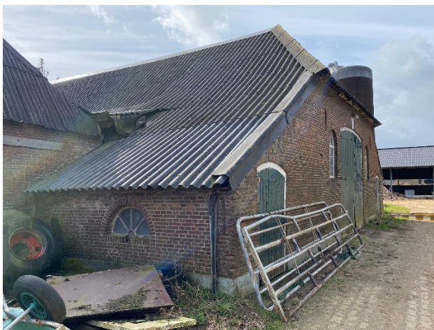
Markante T-boerderij met aangebouwde stenen schuur, sluitsteen met jaartal 1858 boven de deeldeur.
