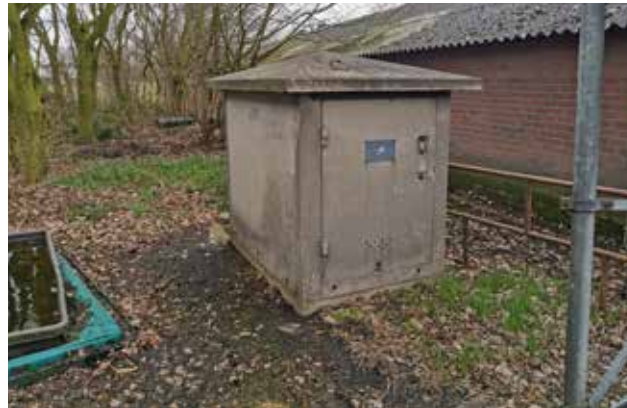
Figuur 13 Aanwezige trafo op het erf
