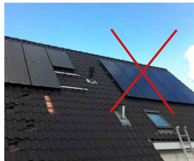
fout voorbeeld van zonnepanelen op het dak
