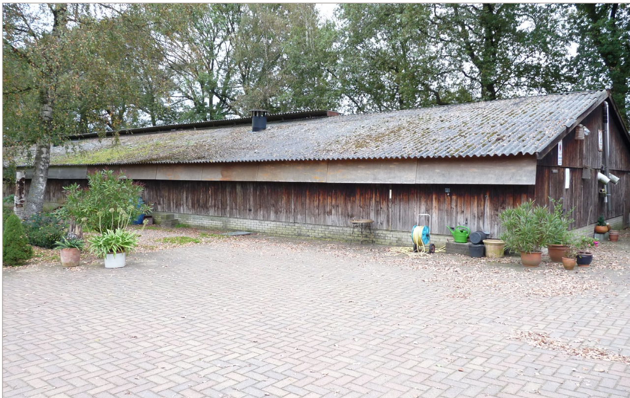
Afbeelding 22. Te slopen kippenschuur
