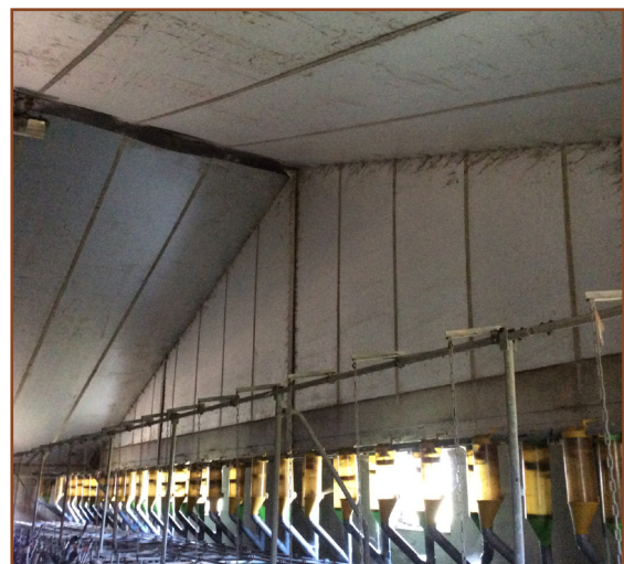
Afb. 3.5: Binnenzijde van een stal. Openingen ontbreken geheel, het gebouw is ontoegankelijk voor bijvoorbeeld vogels en vleermuizen.
