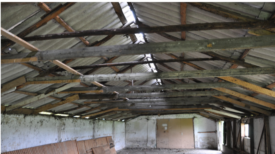
Foto's van enkele van de bebouwing aan de binnenzijde (enkelsteensmuren+ontbreken dakbeschotten).
