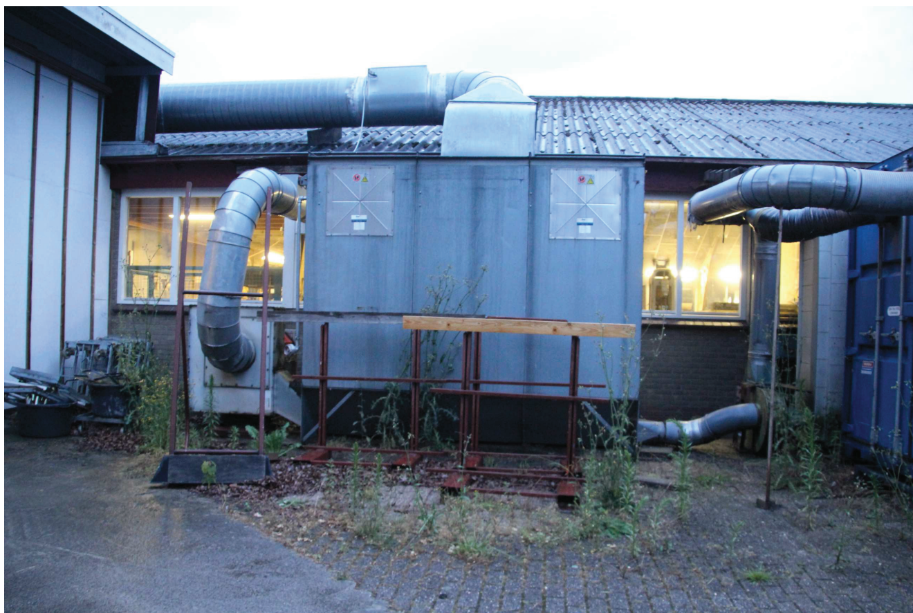
X:\ WISSELDIRECTORY\201500386\06 Werkmap\M\20150702 ██████████ geluidsmetingen\Fotos\066 Timmerfabriek ██████████ al 02-07-2015 - filter installatie.JPG
