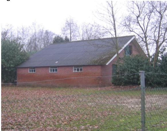
Figuur 4: Asbestverdacht dak
