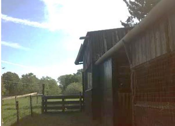
Figuur 6: Asbestverdacht dak
