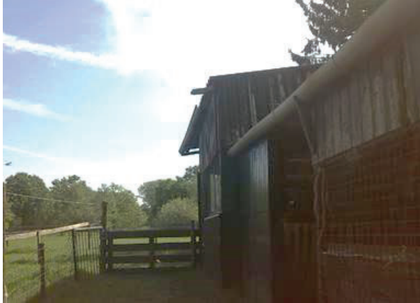
Figuur 6: Asbestverdacht dak
