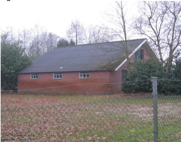
Figuur 4: Asbestverdacht dak
