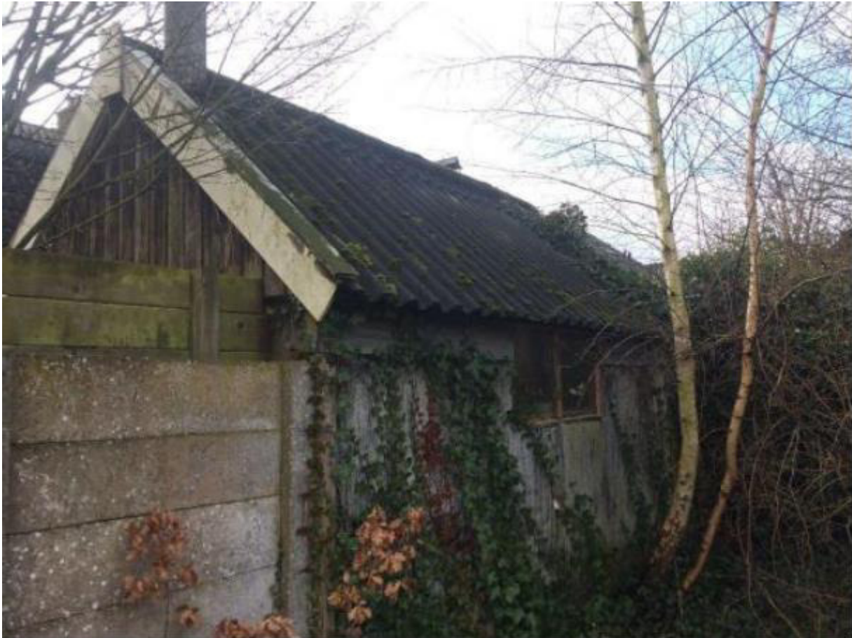
Schuurtje met asbest dak zonder goot.
