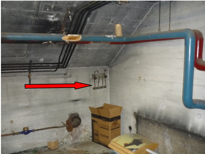
Leidingen naar olietank in kelder
