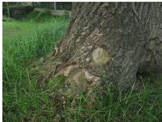
Foto 6: Stamvoetschade door maaierwerkzaamheden
