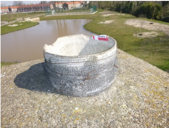
Asbesthoudende buis op schoorsteen
