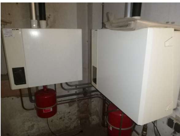
Asbestrijv cv-ketels in kelder
