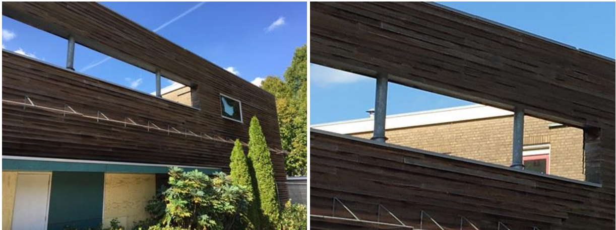
De houten gevelbetimmering en open stootvoegen in de buitenmuur van de woningen op de eerste verdieping.
