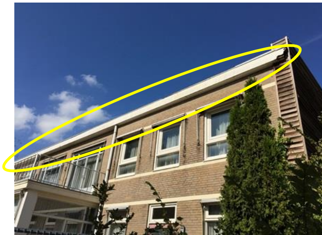
Openingen tussen de buitenmuur en de dakbetimmering.
