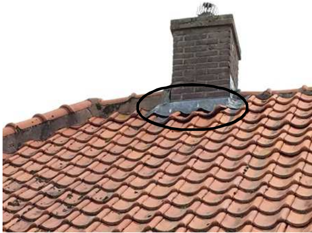
Potentiële invliegopening van vleermuizen naar een verblijfplaats in het dakvlak van een gebouw.
