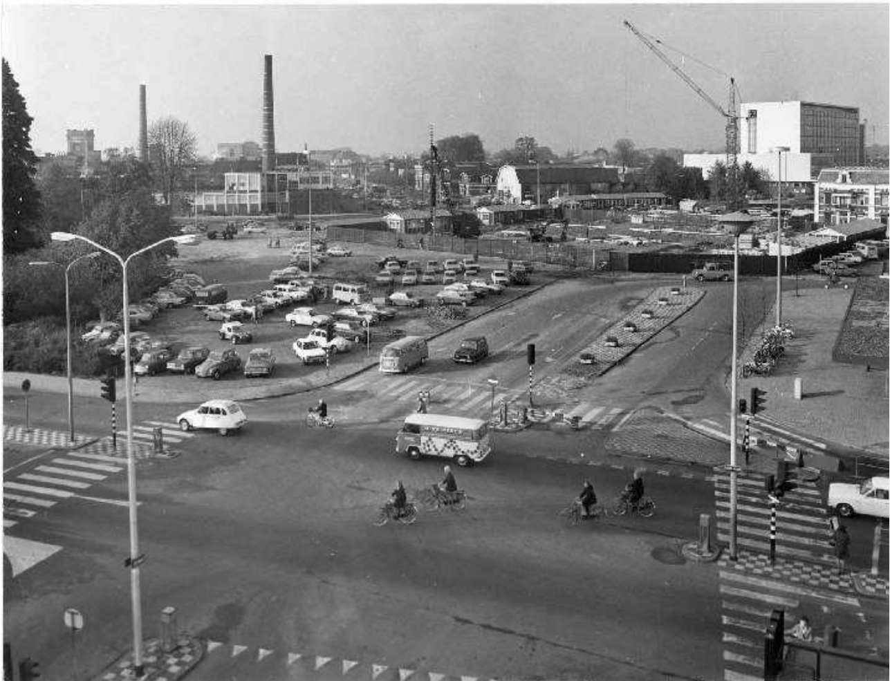
Foto: 12 november 1975 De bouw van de winkelbebouwing ter plaatse van de huidige C&A locatie.
