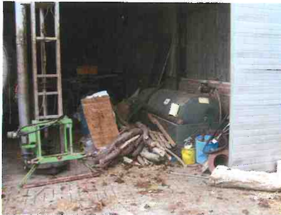
Foto: dieseltank in lekbak
