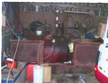
Foto: twee dieseltanks in lekbak
