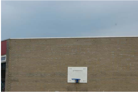
Openstootvoegen in gevel
