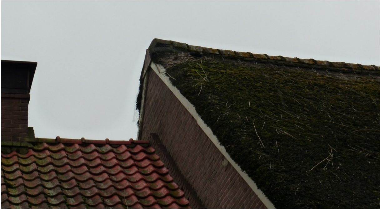
Plek onder de nok waar mogelijk een steenmarter naar binnen is gekomen.
