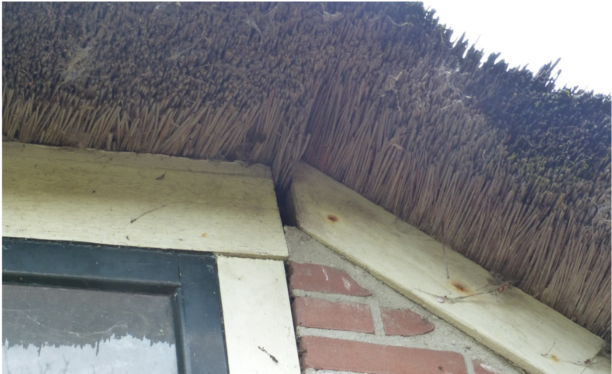
Kier waardoor vogels of vleermuizen door naar binnen kunnen komen. Geen sporen van recent gebruik.
