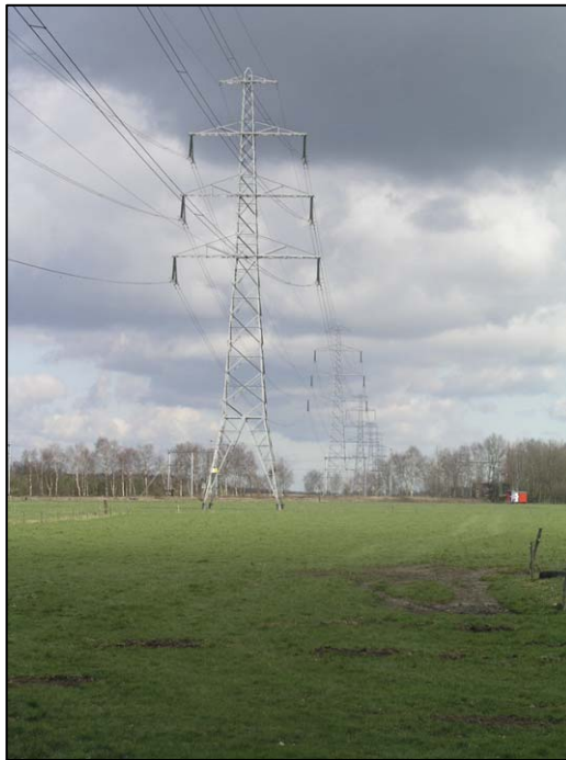
Hoogspanningsleiding Hoogeveen - Beilen
