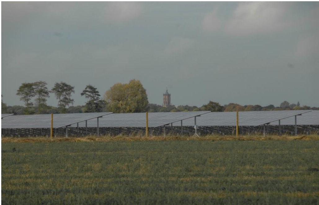
Zonnepark Lingewal Bommel: half zicht op zuidzijde opgestelde panelen, het panelenveld rijgt zich aaneen als één vlak.
