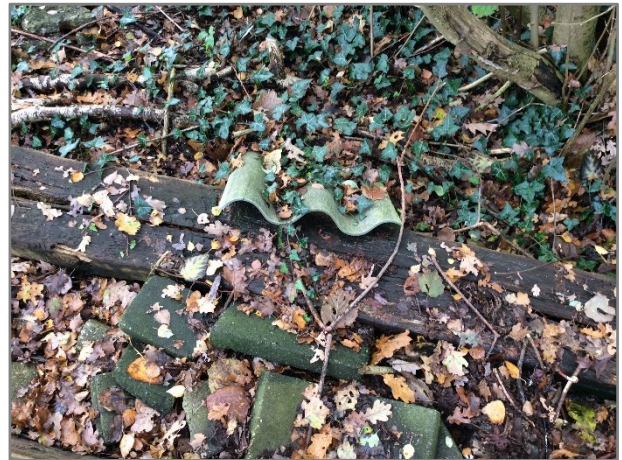
Foto 2: Asbestverdachte golfplaat op maaiveld boring 18
