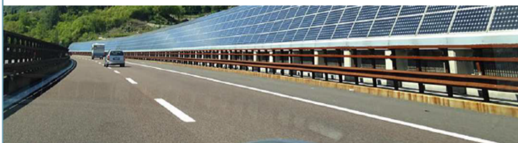
Figuur 19: Zonne installatie langs de "Brennerautobahn", Italië
