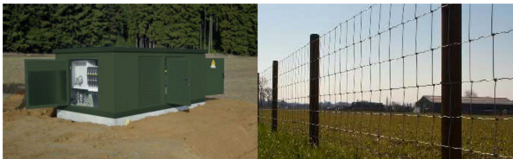
Figuur 15: Foto's van hekwerk en trafo,
