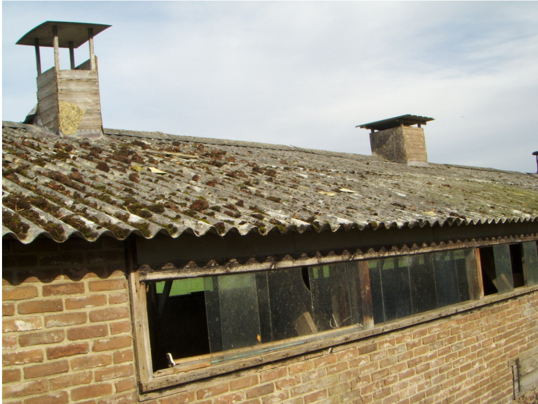
Overzicht verweerde dakbedekking
