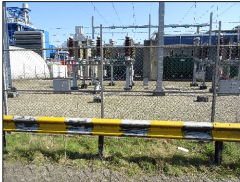
Figuur 4.2. Trafostation GETEC-terrein.
