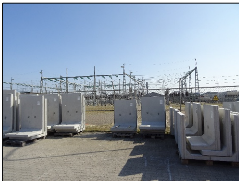
Figuur 4.8. 110 kV-station Bargerveer.
