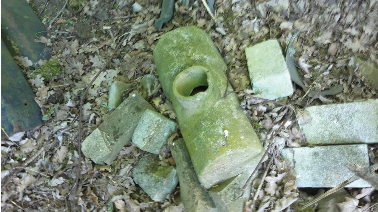
Foto 3. Asbest verdacht gootdeel Bladderswijk O.Z. nr. 92 te Nieuw-Dordrecht.
