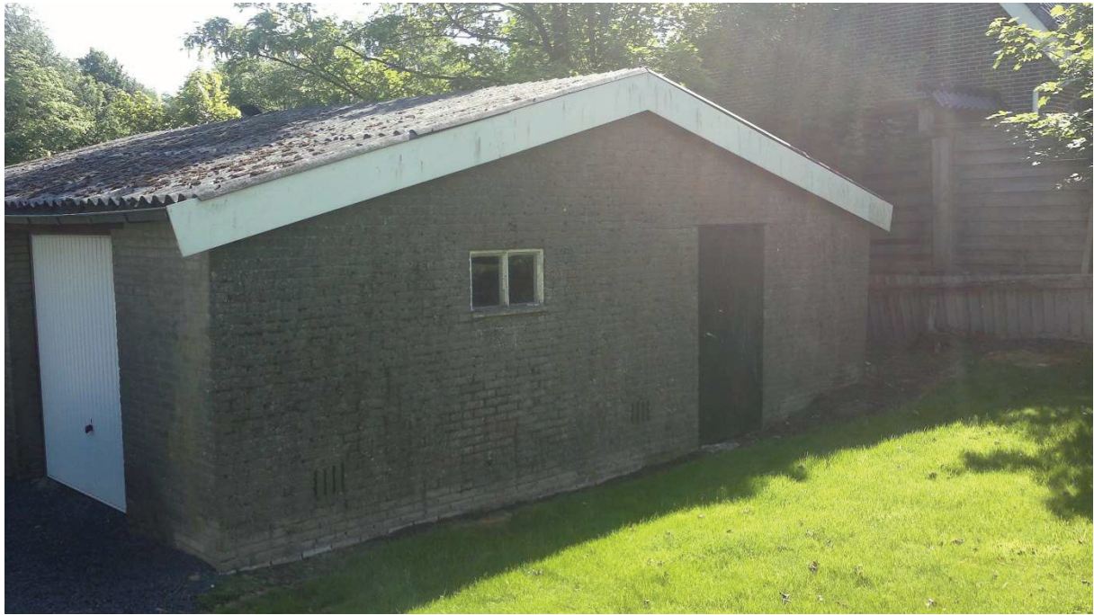
Foto 1. Schuur Bladderswijk O.Z. nr. 92 te Nieuw-Dordrecht.
