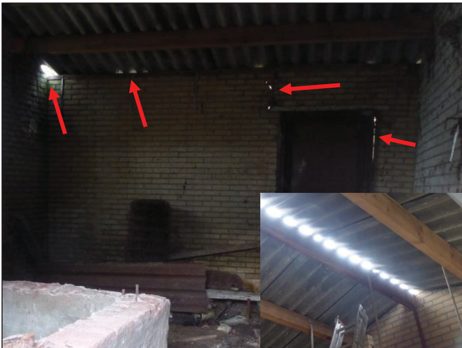
Foto 4 De schuur is vrij open, met gaten en kieren in zowel het dak als in de muren (rode pijlen).
